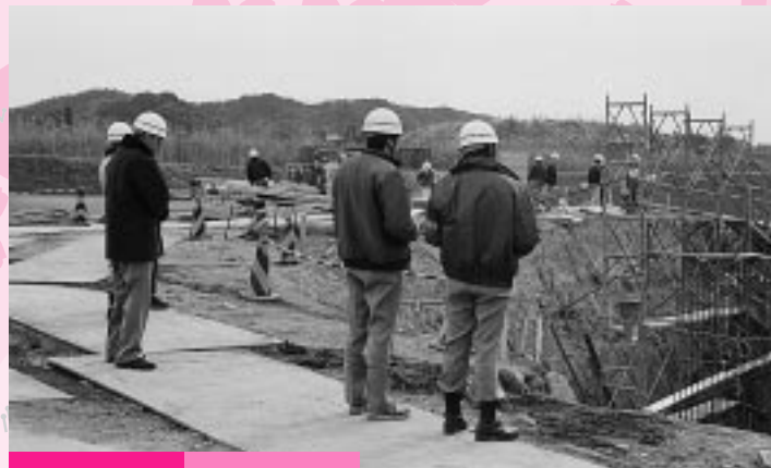
平成12年12月14日、年末官民合同安全パトロールを実施。工事現場での安全点検。
